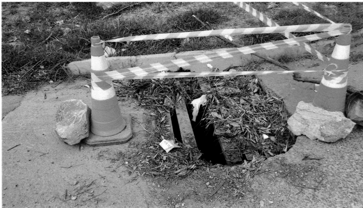
Foto 05 – boca de lobo, Rua Luiz Feitosa Rodrigues esquina com Rua Dom Pedro II – dispositivo antigo sem uma das peças de trilho. Manutenção em execução com sinalização já executada.
