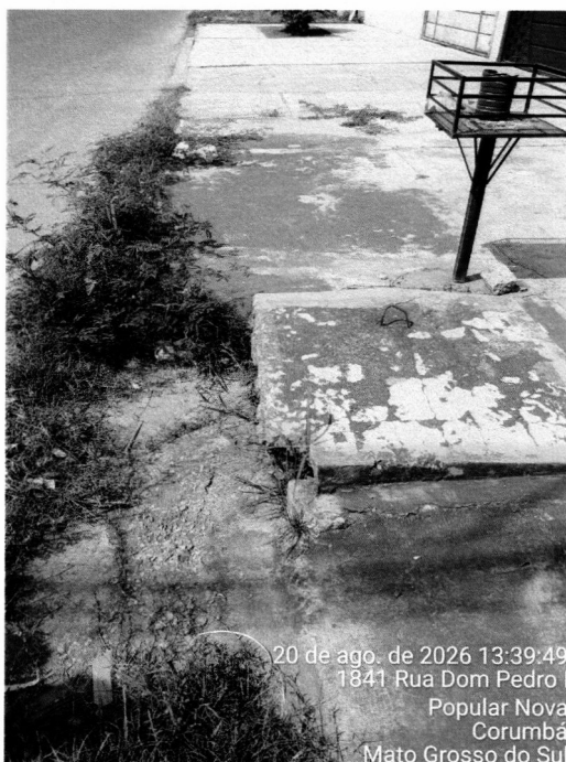
Foto 02 – Caixa de passagem, Rua Luiz Feitosa Rodrigues esquina com Rua Dom Pedro I – dispositivo em bom estado de conservação, necessitando de limpeza e encaixe, já em execução.
