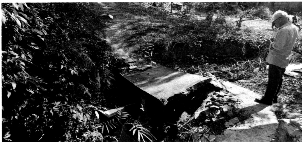
Foto 01 – Passagem corrompida, entulhos obstruindo o fluxo de água
