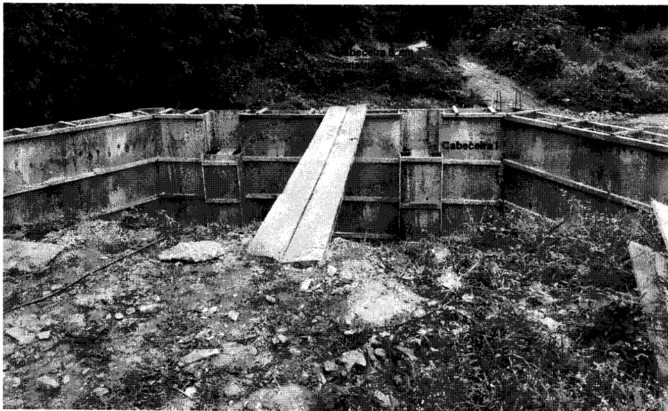
Vista interna da caixa de contenção da base de apoio, ao fundo, local da segunda base de apoio.
